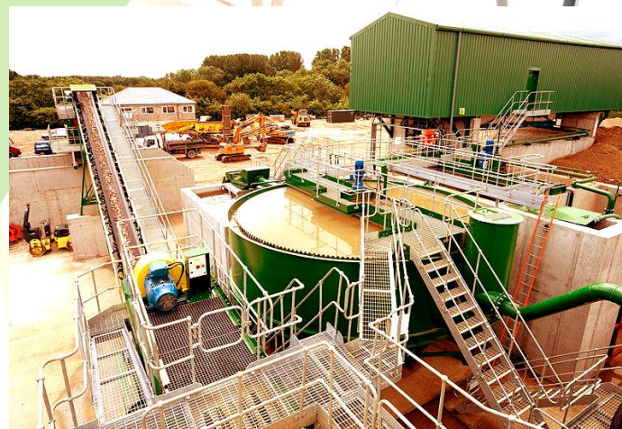
Instalaciones de separación y reciclaje para RCD
